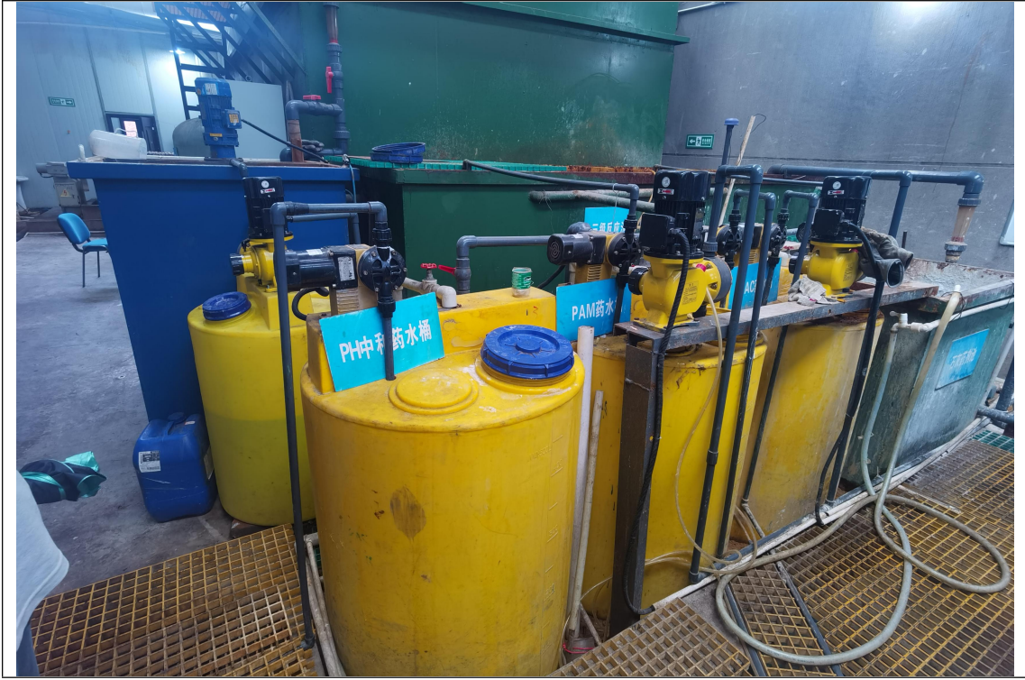
图 4.1-2 厂内污水处理站现场图
