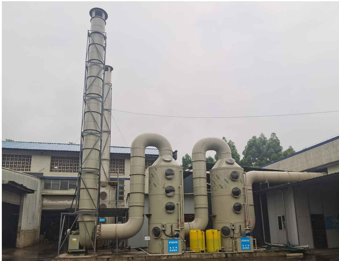
废气处理设施喷淋塔
