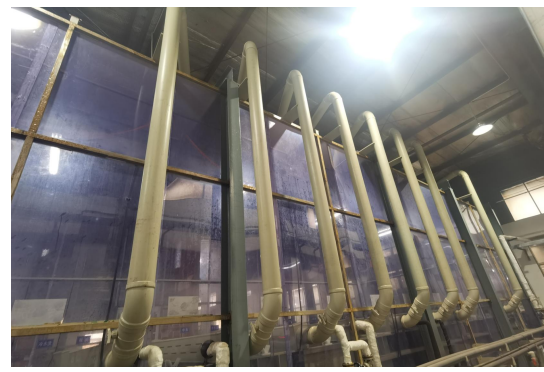
废气收集管道
